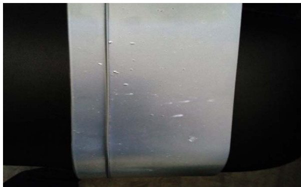
Рис. 23. Образование бугорков на покрытии
